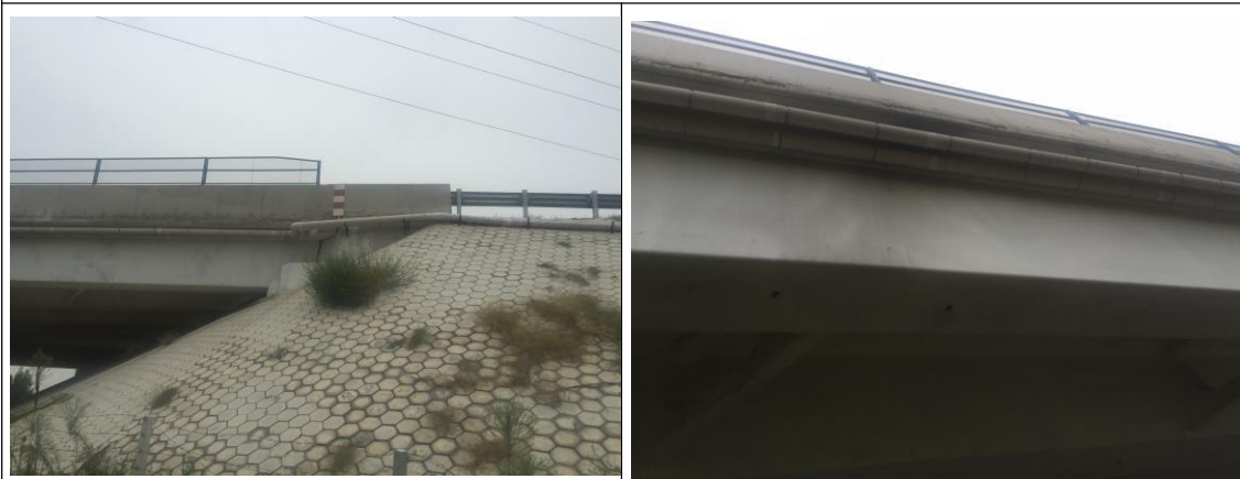
桥面排水系统
